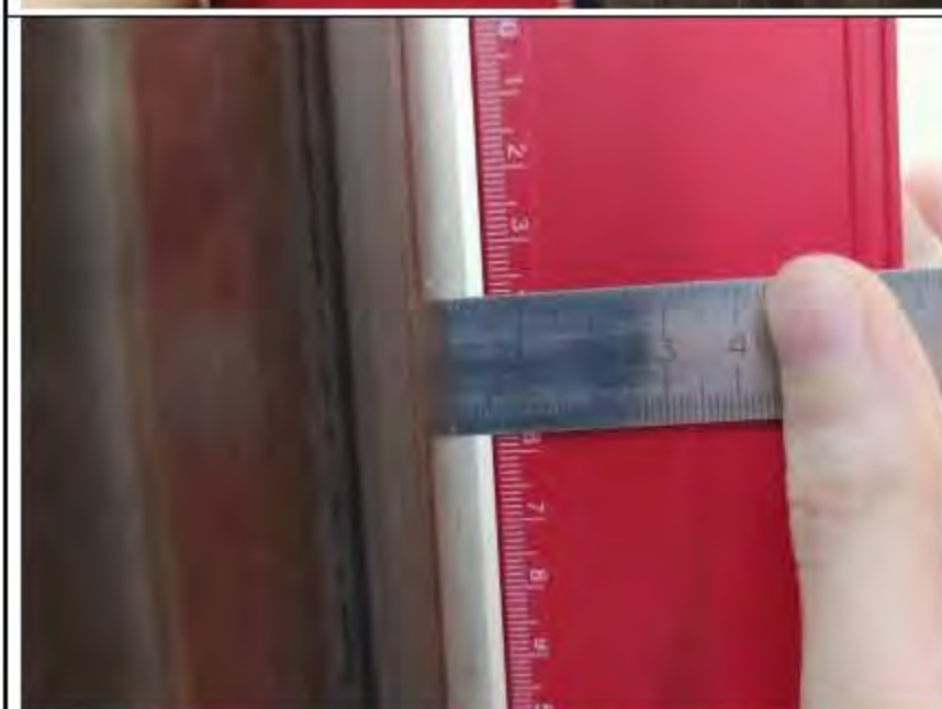
Фото №44. Отклонение коробки дверного блока в санузле.
