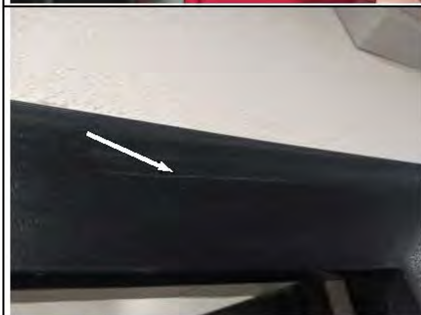
Фото №69. Коробка входной металлической двери имеет дефекты (царапина).
