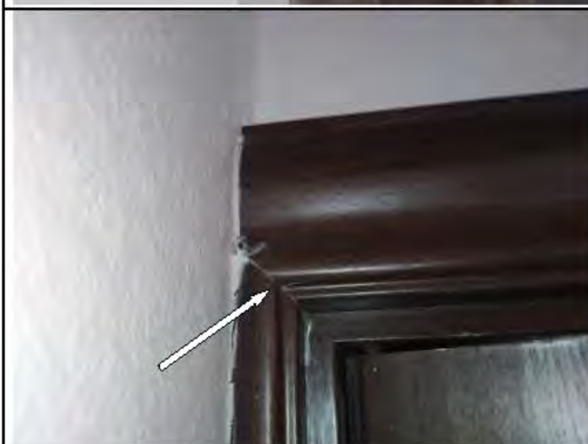
Фото №54. Дефекты (царапина) на наличнике межкомнатной двери в гостиной.
