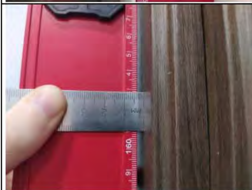
Фото №45. Отклонение наличников дверного блока в ванной комнате.
