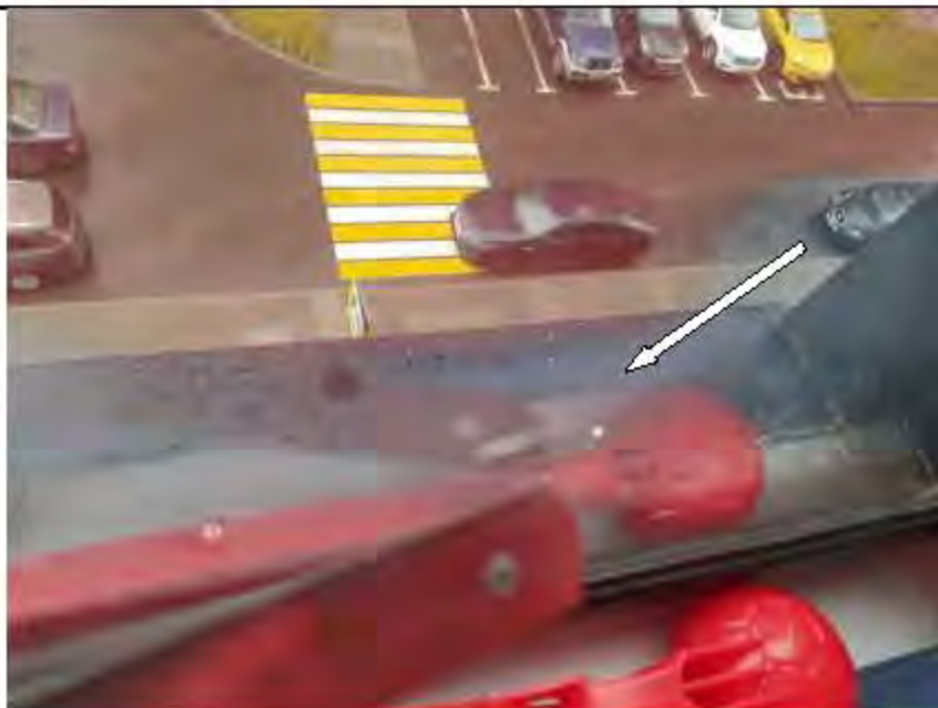
Фото №31. На стеклопакете оконного блока на лоджии имеется дефект (царапина).
