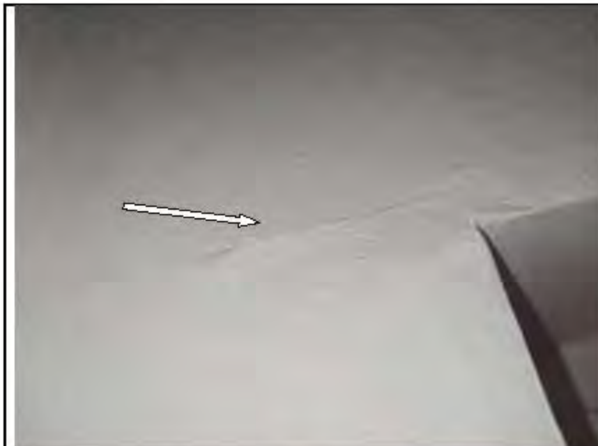
Фото №61. Дефект поклейки обоев в спальне (отклеивание).
