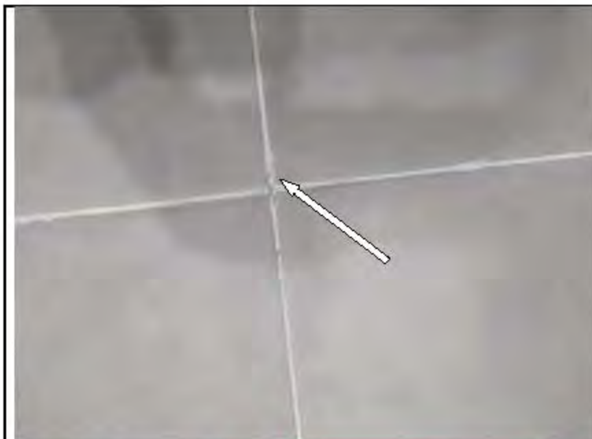
Фото №67. Затирка напольной плитки в ванной комнате выполнена с нарушениями (каверны).
