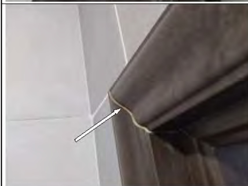
Фото №53. Элементы дверного блока соединены не надежно в санузле.
