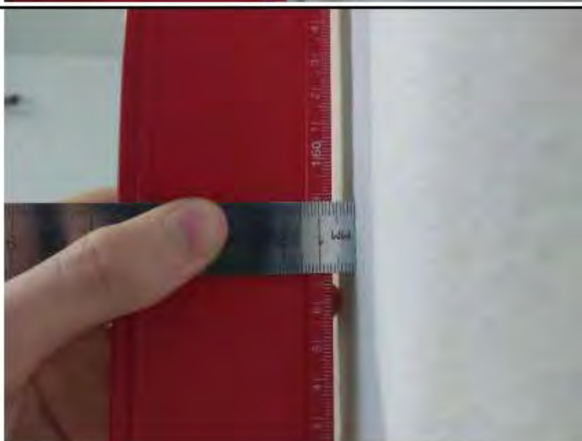
Фото №9. Измерения уровня стен в спальне.
