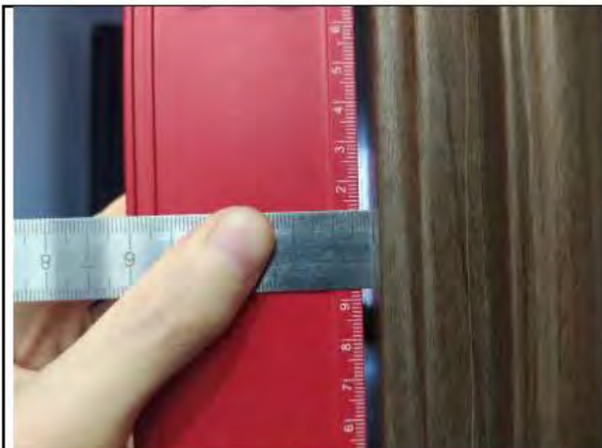
Фото №43. Отклонение коробки дверного блока в спальне.
