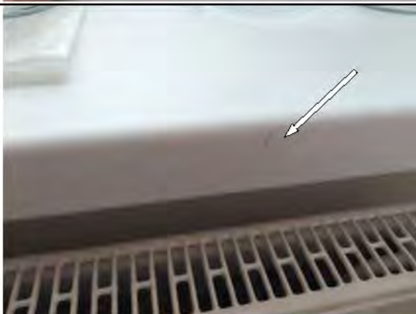
Фото №33. На лицевой поверхности подоконной доски оконного блока в кухне имеются дефекты (загрязнение малярными составами).
