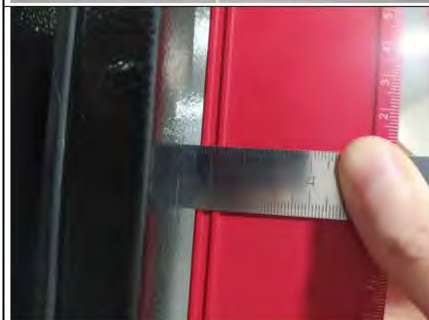
Фото №68. Отклонение коробки входного дверного блока
