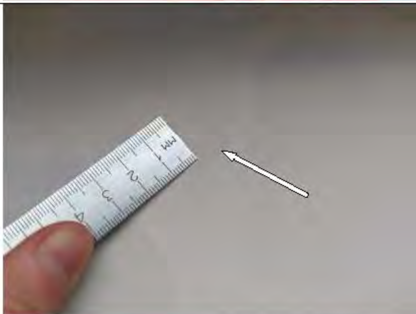
Фото №32. На лицевой поверхности подоконной доски оконного блока в кухне имеются дефекты (царапина).
