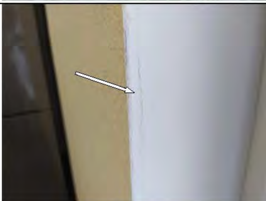
Фото №18. Отлупы на окрашенной поверхности откосов оконного блока в кухне.
