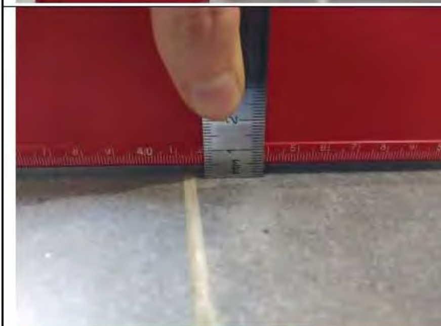
Фото №14. Измерения уровня напольного покрытия в кухне.
