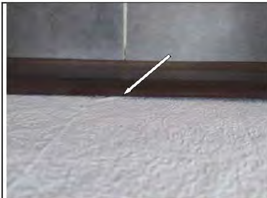
Фото №58. Напольный плинтус ПВХ в кухне неплотно прилегает к стене (отходит), образуется зазор.
