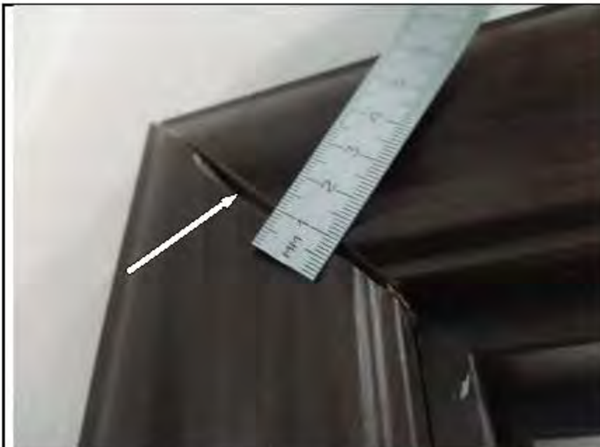
Фото №52. Элементы дверного блока соединены не надежно в ванной комнате.
