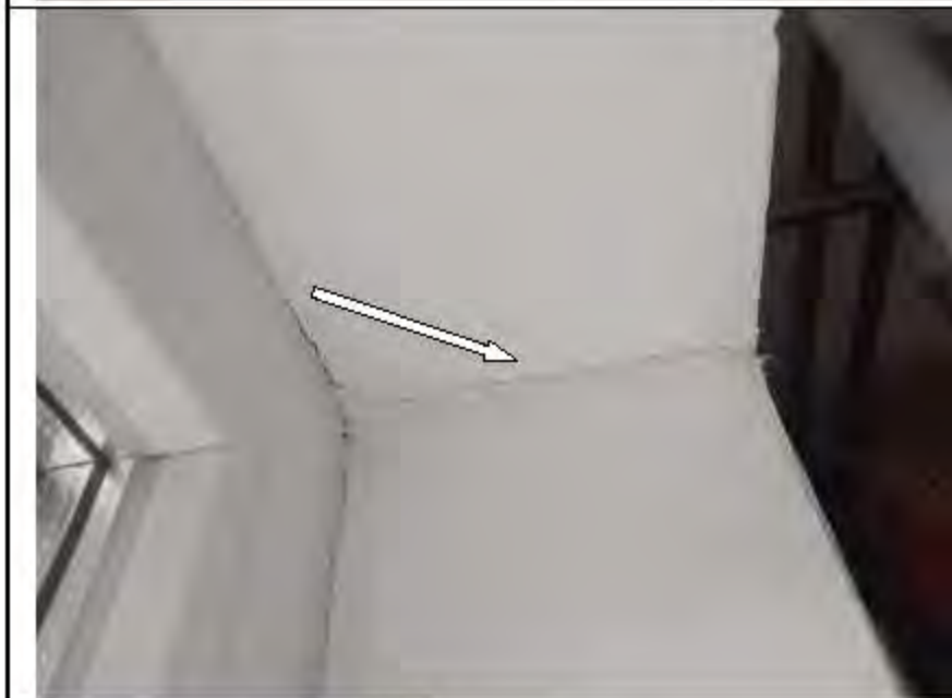
Фото №20. Трещины на окрашенной поверхности откосов оконного блока в гостиной.
