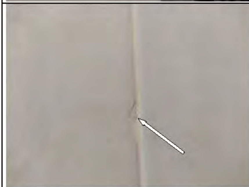
Фото №63. На настенной керамической плитке в санузле имеются дефекты (отбитость).
